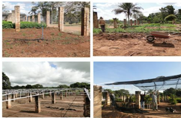
Figura 1. Fotos do viveiro antes e durante a reforma de pilares e cobertura.
